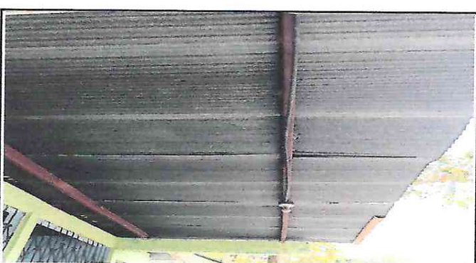
Foto 4: Lamina dañada e insegura por falta de mantenimiento
