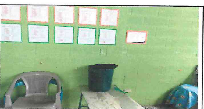
Foto 6: Falta de area para lavar, picar y preparar alimentos
