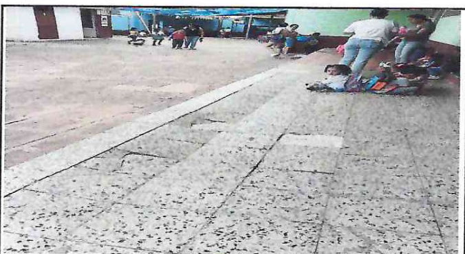
Foto 3: Piso del corredor aulas 4 y 5 con hundimiento y dañados
