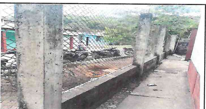
Foto 5: Muro inseguro y dañado por intentos de acceder a la escuela
