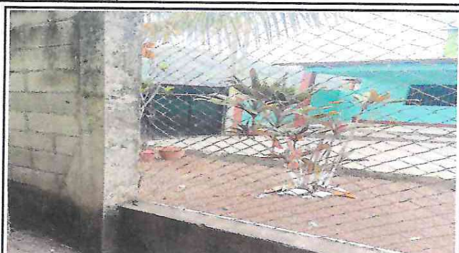
Foto 2: Muro malla dañado y con riesgo para los niños
